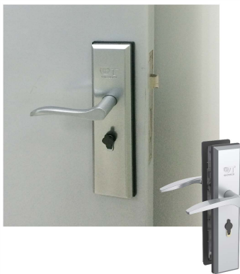
机房房门闭锁案例
