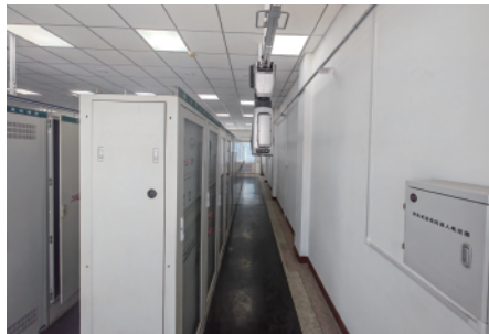
轨道机器人巡检
